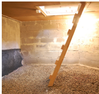
Oinredd källare, saknar golv och väggbehandling.
