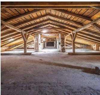
Oinredd vind saknar golv och väggbehandling.
