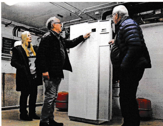
Värmepumpanläggningen i bygdegården
